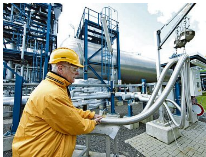
Brandenburg, Schwarze Pumpe: die ehemalige CO 2 -Pilotanlage von Vattenfall
